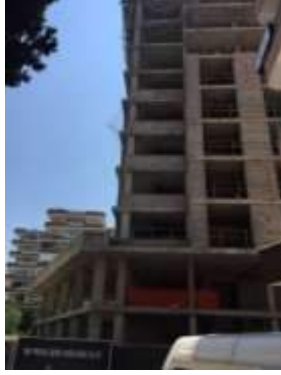
Şekil 3. Seyhan’da yapım süreci devam eden binanın mevcut halini gösteren resim (genel görünüm)
