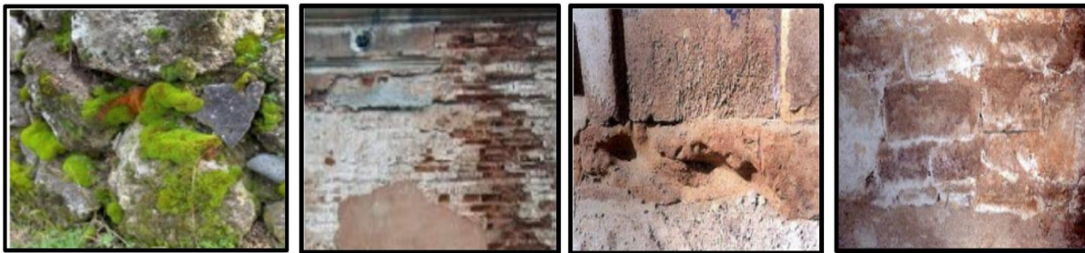
Şekil 2. Dış etkilerle oluşan yapı hasarı örnekleri (Okumuş, 2021)
