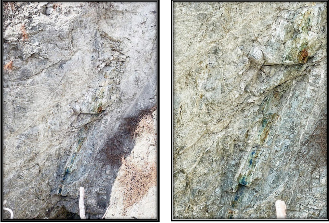
Şekil 4.2. Çalışmanın bölgesindeki yarık duvarlarında gözlemlenen azurmalahit damarları.
