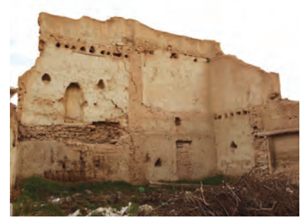
6. Ahşap kirişleri sökülüp alınarak kaderine terk edilmiş bir ev
